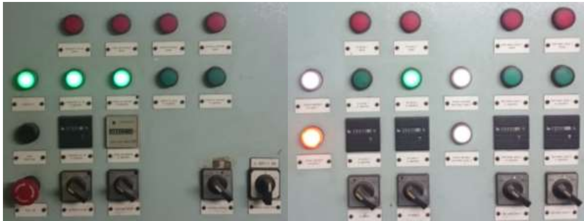
Rys. 2.1 Przełączniki ręczne sterowania lokalnego palnikiem kotła
